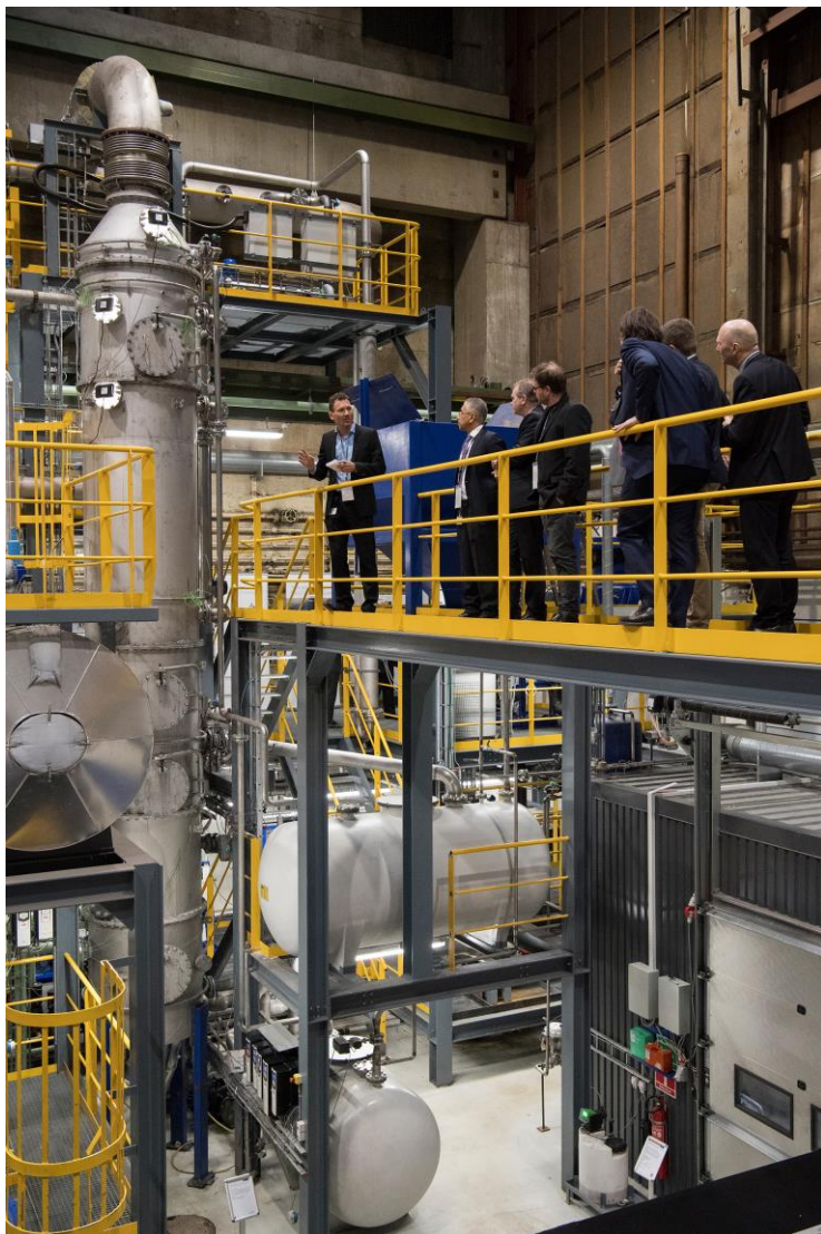
PureSOx Exhaust Gas Cleaning in het Alfa Laval Test & Training Centrum
