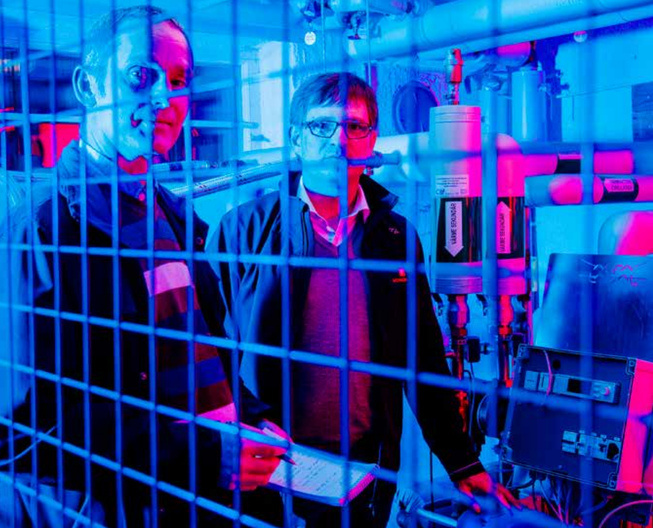
Mats Persson d'Alfa Laval, à gauche, et Kristian Olsér, chef des opérations à Ronnebyhus, dans le sous-sol d'un immeuble. Les économies d'énergie totales s'élèvent à près de 50 %.
